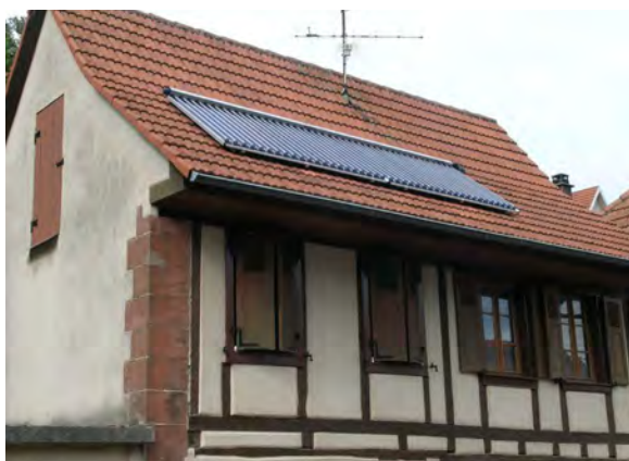
Un exemple d'installation valorisant l'énergie solaire
